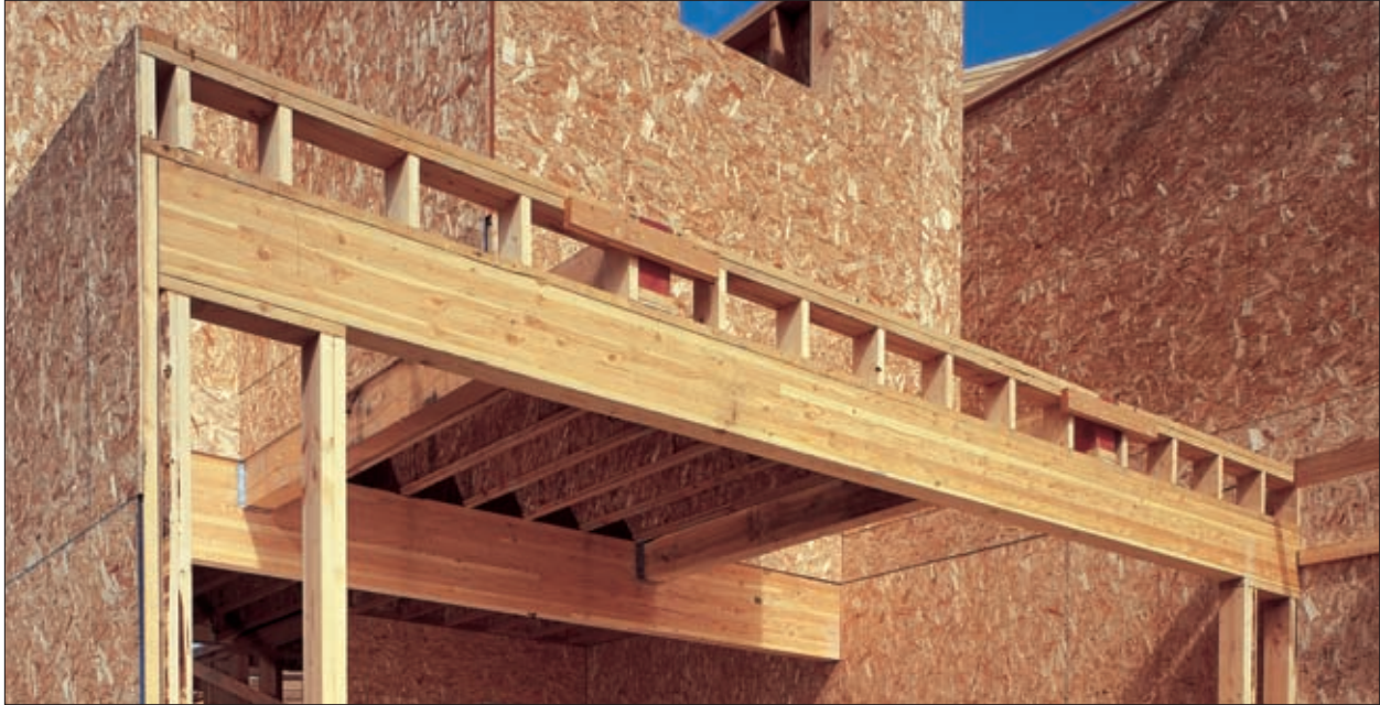
Una viga cabezal de glulam de puerta de cochera se extiende sobre las paredes angostas cortantes. (Vea la figura 4 para más detalles.)
