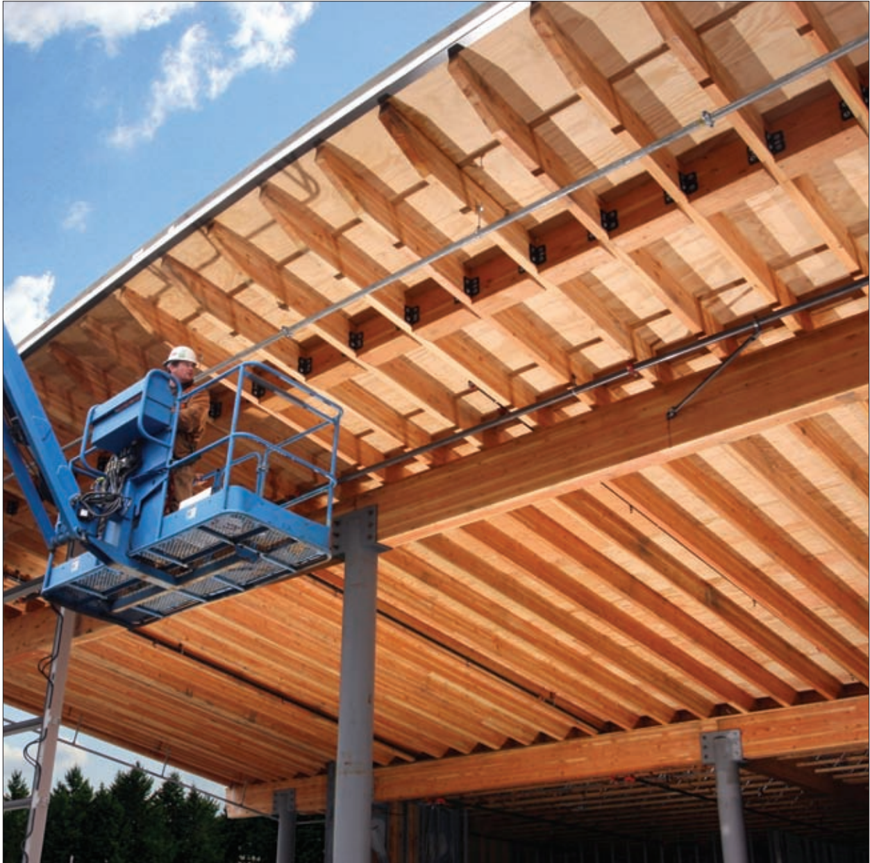
Se utilizó glulam de grado arquitectónico para apoyar el atrio del edificio Garfield Commons en la Universidad Pacific Lutheran en Tacoma, Washington.
