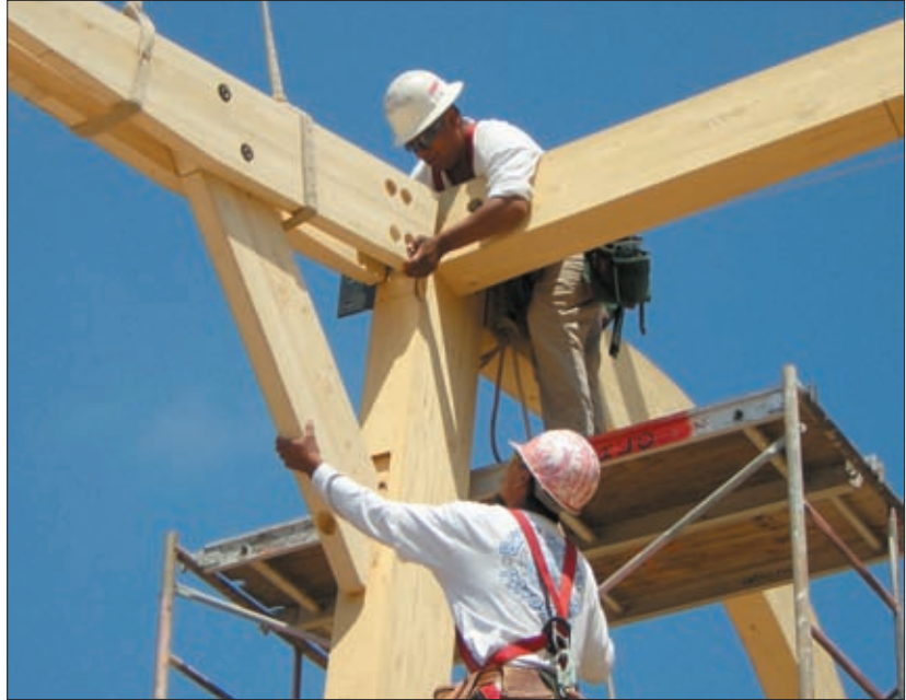
Los agujeros y las muescas se deben colocar de manera precisa a efectos de la apariencia arquitectónica, y se deben tomar en cuenta en el diseño de los conectores estructurales de las vigas y la capacidad de las columnas.
